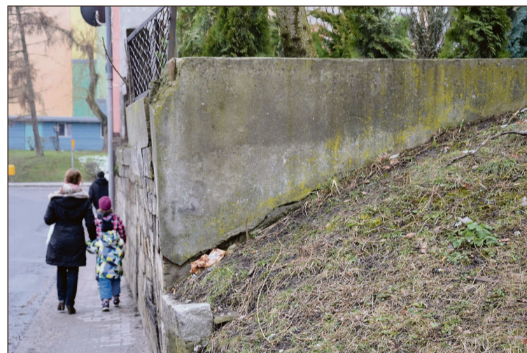
Walący się mur przy ul. Krzywoustego
