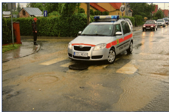
Ciśnienie wody na ul. Hożej wyrwało właz studzienki i przesunęło go o kilka metrów
