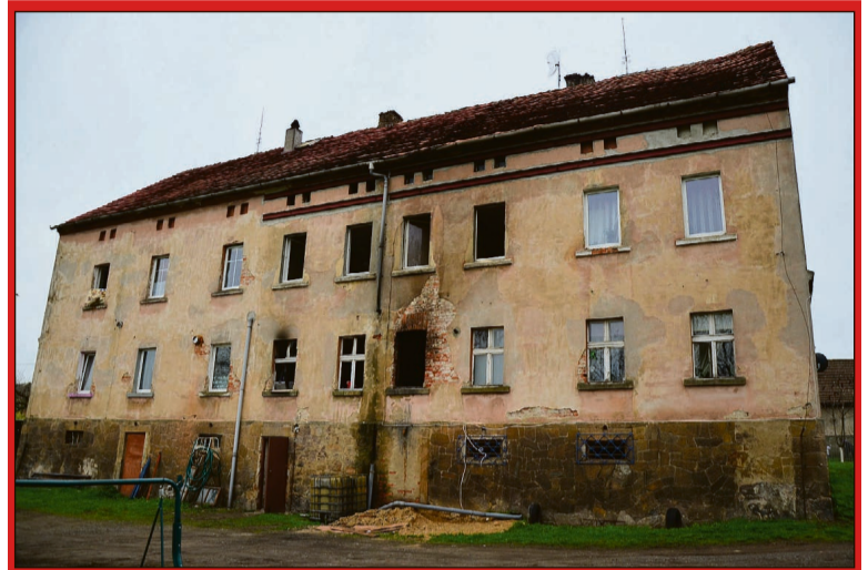
Budynek, w którym doszło do pożaru
